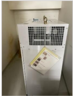
室内に設置したコンプレッサー
