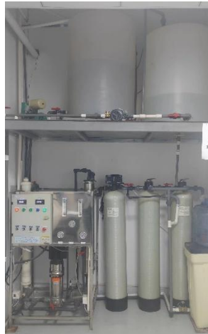
浄水処理装置
